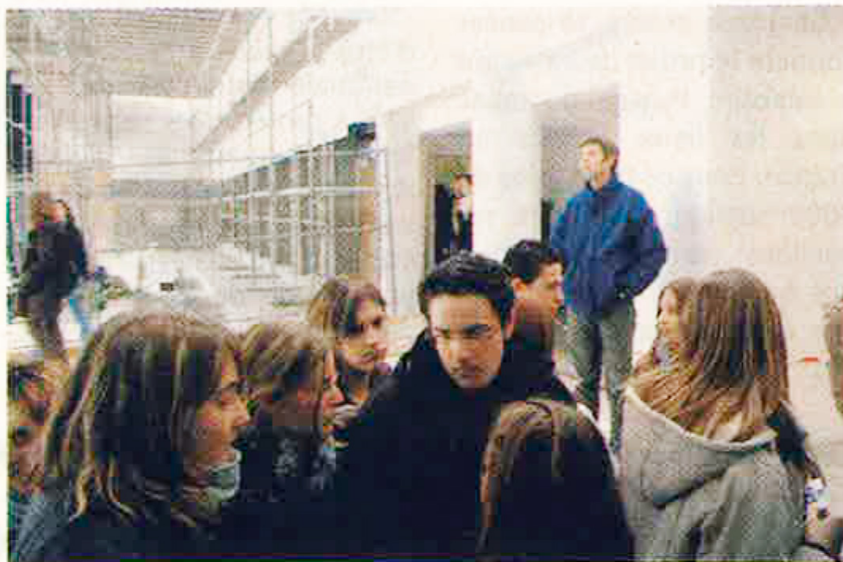
C'est ici que les élèves patientent avant d'accéder à la cantine. Juste à côté des échafaudages. (Photo DNA)
